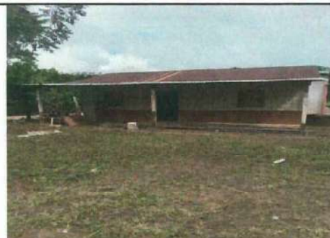
Foto 4: En esta fotografía se observa el Módulo 4 referente a la cocina la cual requiere urgentemente cambio de techo, costaneras y pared ya que actualmente se encuntran en pésimo estado.
